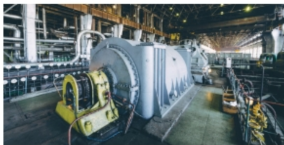
Turbina parowa w elektrowni ciepłej
